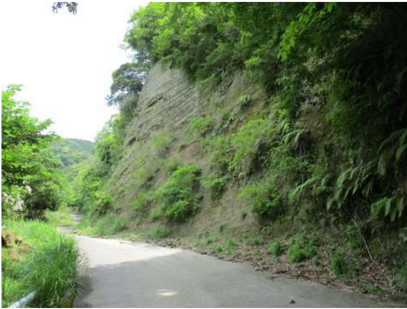
千葉県が海中に在った時代、土砂が年輪のように積み重なった様子が観察できる
