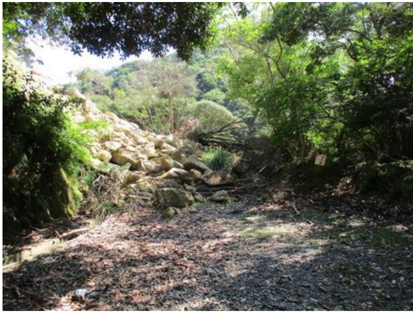
山側の崖が崩れて、岩屑が道路を塞いでいる
