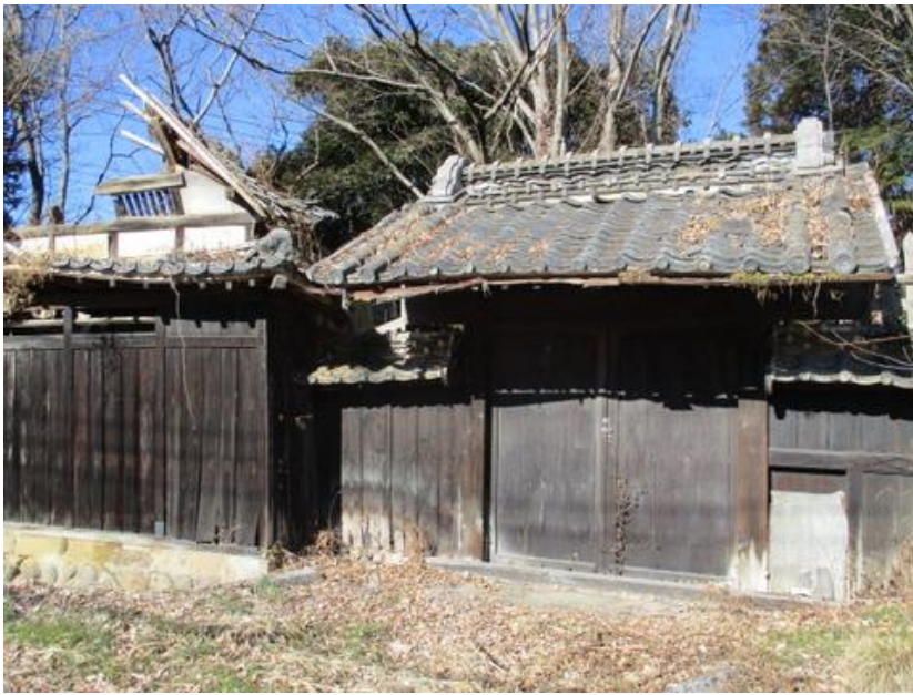
ご時世なのだろうか、門扉の付く屋敷が荒れ放題となっていた
